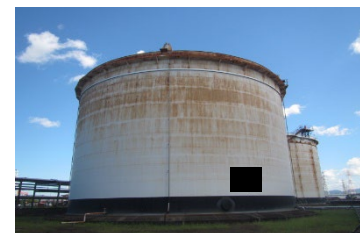
屋外タンク貯蔵所
