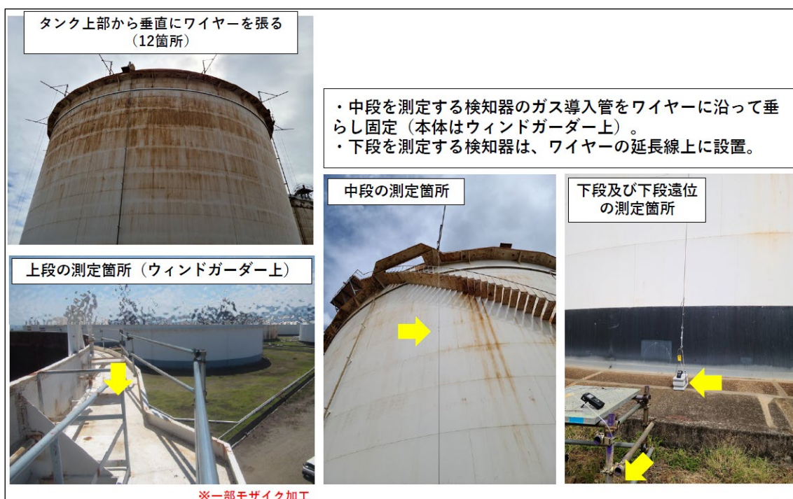
図2-8 ガス検知器設置状況（浮き屋根を有する屋外貯蔵タンク）
