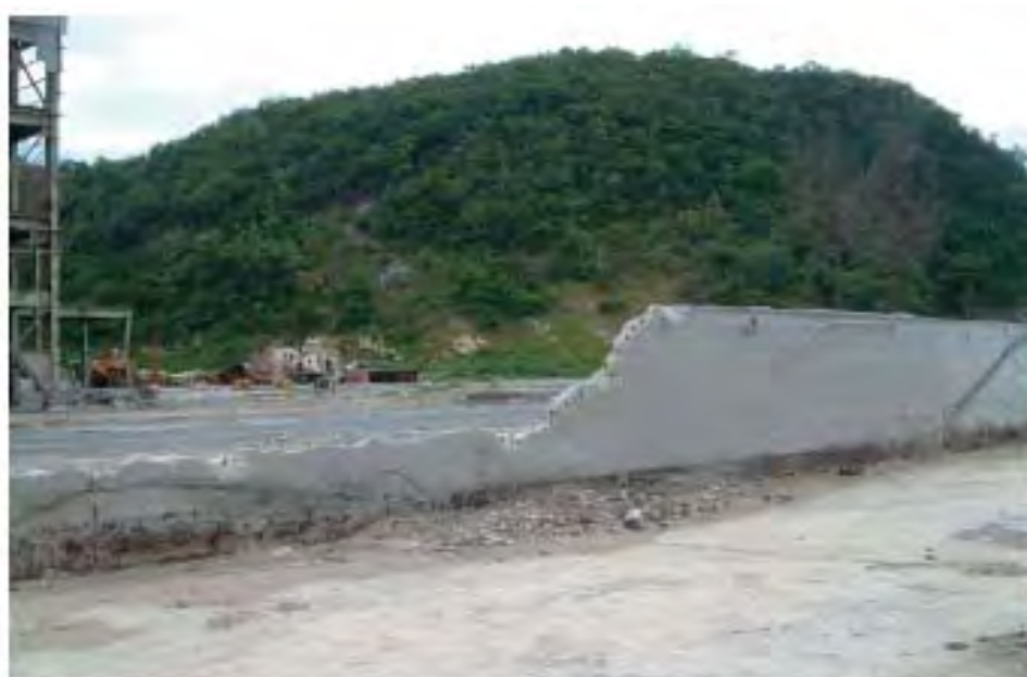
写真 2.1-6 防油堤の被害状況（文献 1-6 から引用）
