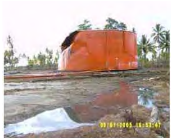
(2) 被災後（空のタンク）
