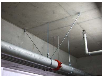
B種耐震支持設置状況
