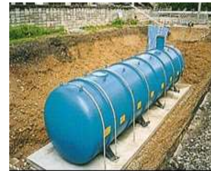
(耐震性貯水槽) 【補助対象の例】
