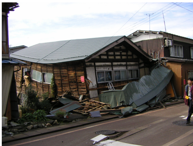
建物被害（川口町内）
