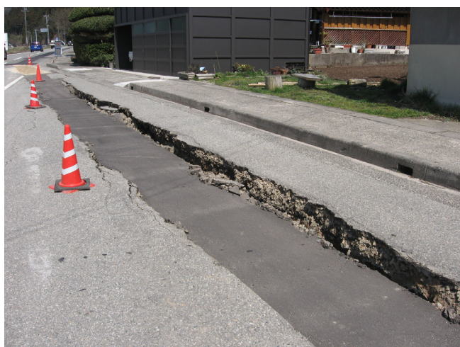
道路被害（輪島市門前町内）
