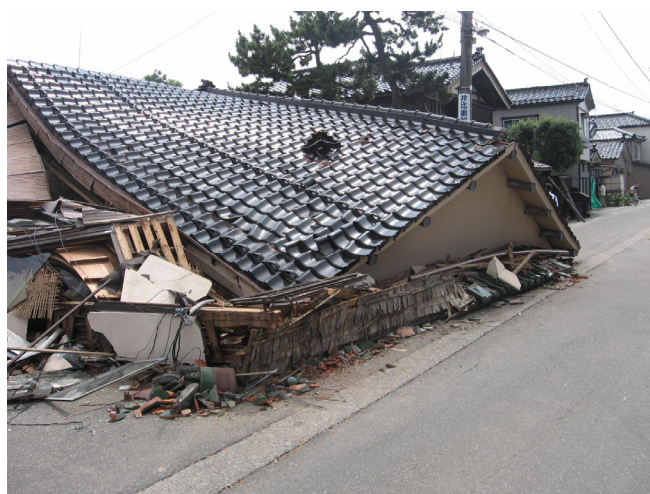
建物被害（柏崎市内）
