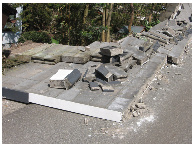
ブロック塀の倒壊（輪島市門前町内）
