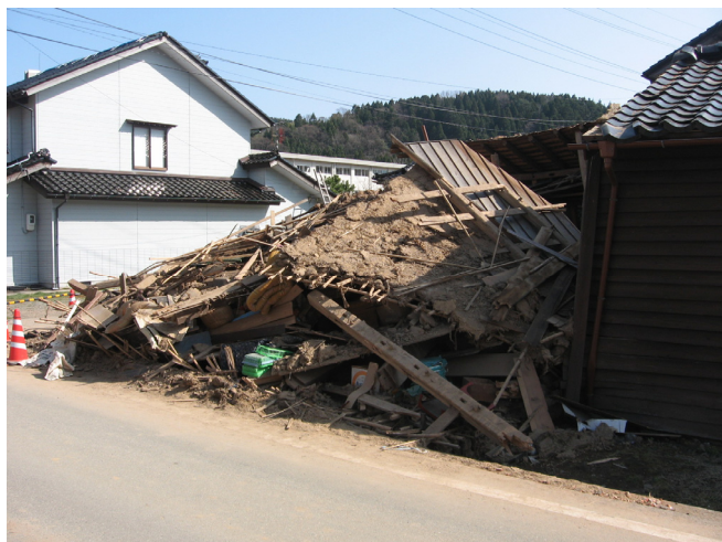
建物被害（輪島市門前町内）
