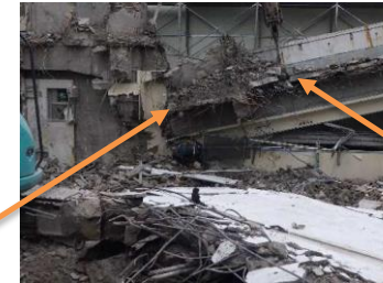
【建物崩壊現場】
