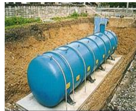
【耐震性貯水槽】
