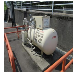
災害対応型LPガスバルク供給システム
