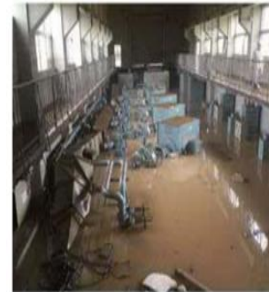
浸水被害を受けたポンプ施設
