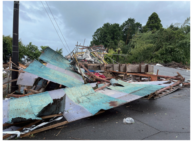
被害の状況1 (宮崎市消防局提供)
