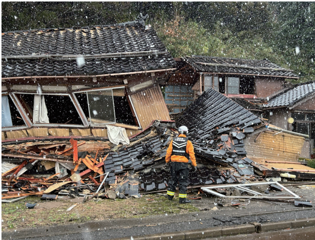
珠洲市正院町家屋倒壊現場
