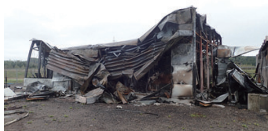
火災後の蓄電池設備建屋
