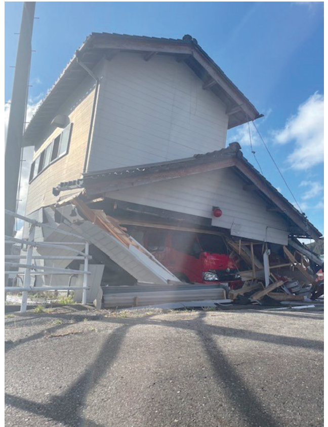
倒壊した輪島市門前分団詰所の様子 (輪島市消防団門前分団員提供)
