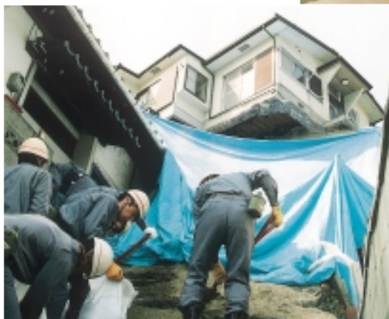
芸予地震後に住宅地の崩落対策を行う消防団
