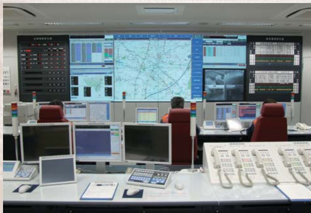
3月16日から運用を開始した新通信指令施設
