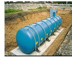
【耐震性貯水槽】
