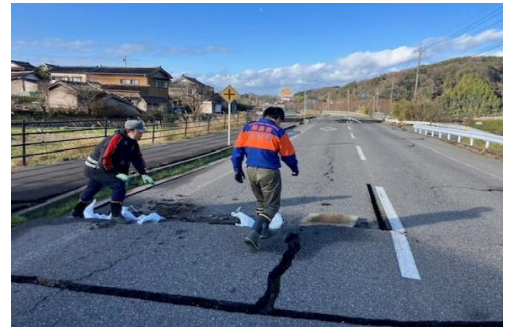
輪島市消防団による亀裂の入った道路補修の様子 (輪島市消防団門前分団員提供)
