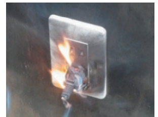
トラッキング火災に注意！
