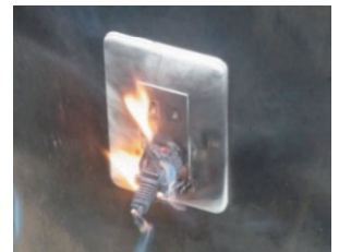
トラッキング火災に注意！
