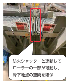
写真9 コンベアのシャッター連動設備
