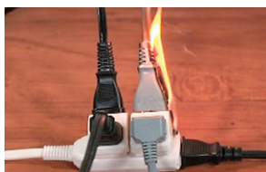
テーブルタップ自体が過熱 たこ足配線による火災
