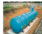
(耐震性貯水槽)
