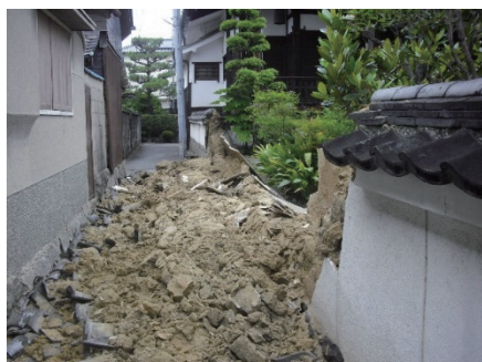
【地震で壊れた堀】
