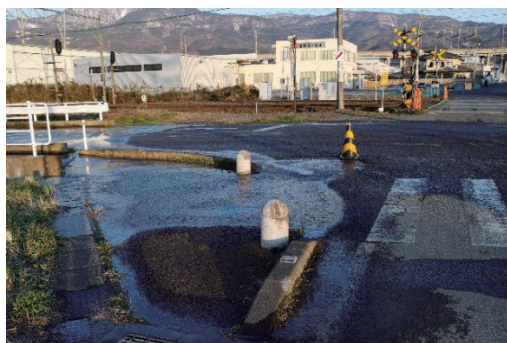
漏水が発生した小坂踏切前
