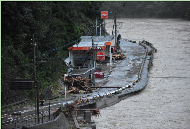
台風第 14 号で被災した国道 327 号周辺（諸塚村役場提供）
