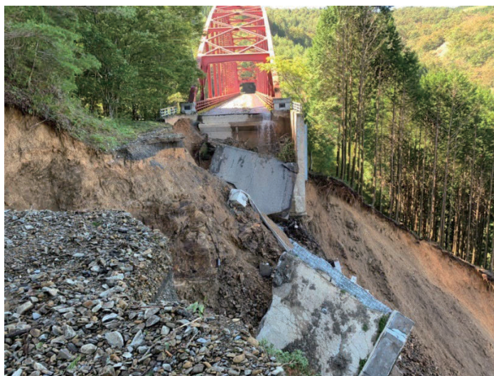
県道 142 号奥椎葉橋の土砂災害（写真・椎葉村提供）
