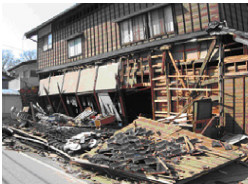
激しい揺れにより、住宅が被害を受けます。
