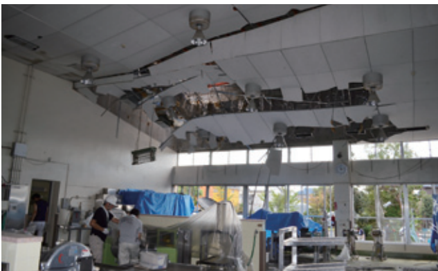
平成25年9月の越谷市竜巻被害の状況 (提供：埼玉県越谷市)
