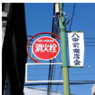
消火栓標示板
