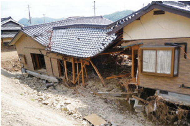
堤防の近くに建つ家の被害(佐用町)
