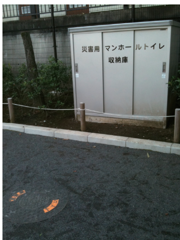
災害用マンホールトイレ
