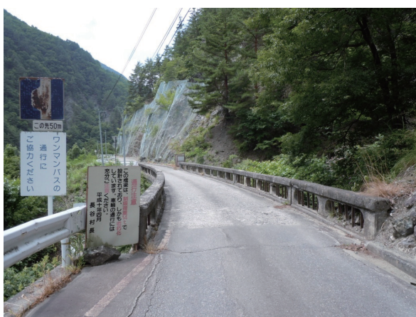
土砂崩れが起こりそうな場所
