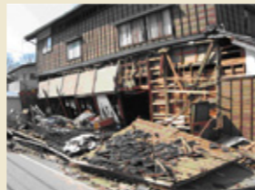
平成19年の能登半島地震による被害 (石川県輪島市)
