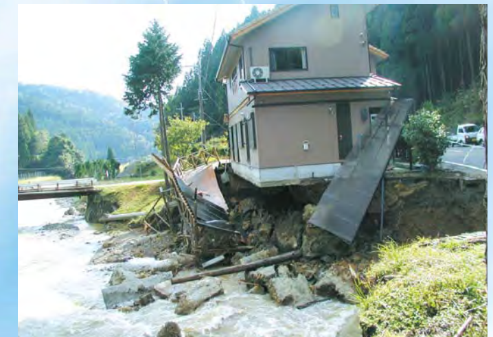
木住川の洪水で土地がえぐられた住宅(旧日吉町)
