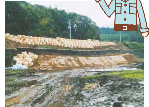
一日も早い運転再開をめざした復旧工事(KTR宮村駅付近)
