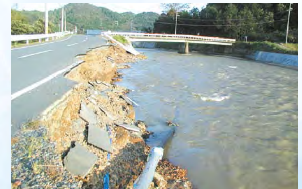
護岸が崩れた高屋川(旧丹波町)
