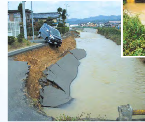
道路が崩れた安場川(綾部市上延町)
