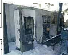
焼損した注油設備等
