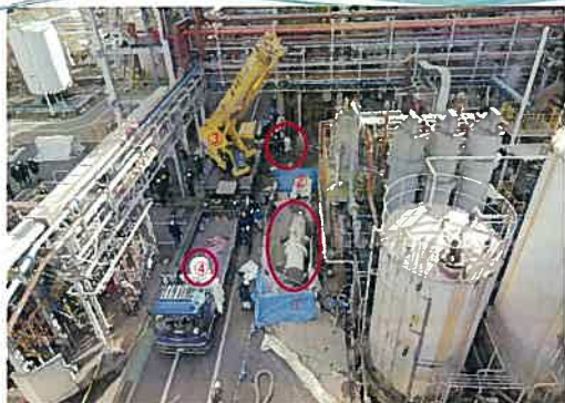
①爆発した熱交換器(手前が下部側)。 ②吹き飛んだ上部側カバー ③クレーンは、上部側カバー及び本体を吊っていたもの。 ④トラックの荷台に午前中に取り外した下部側カバーが置いてある。
