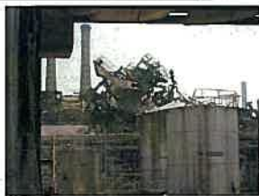
レゾルシン製造装置(西側から)
