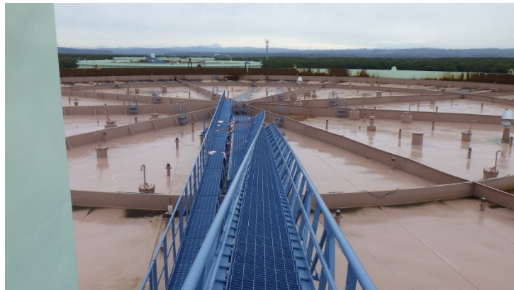
破損したローリングラダー（浮き屋根式屋外貯蔵タンク）
