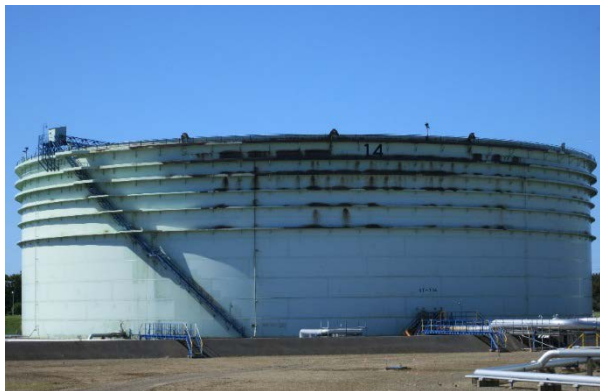
浮き屋根式屋外タンク貯蔵所の上部から流出した原油の痕
