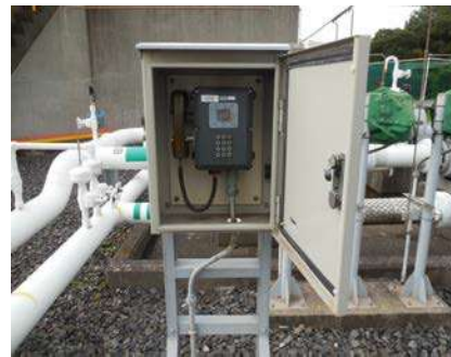
写真6-3-2 構内電話の例
