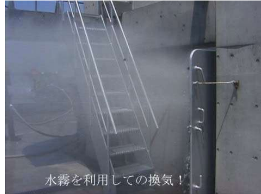
写真3-1-5 水霧による換気の状態
