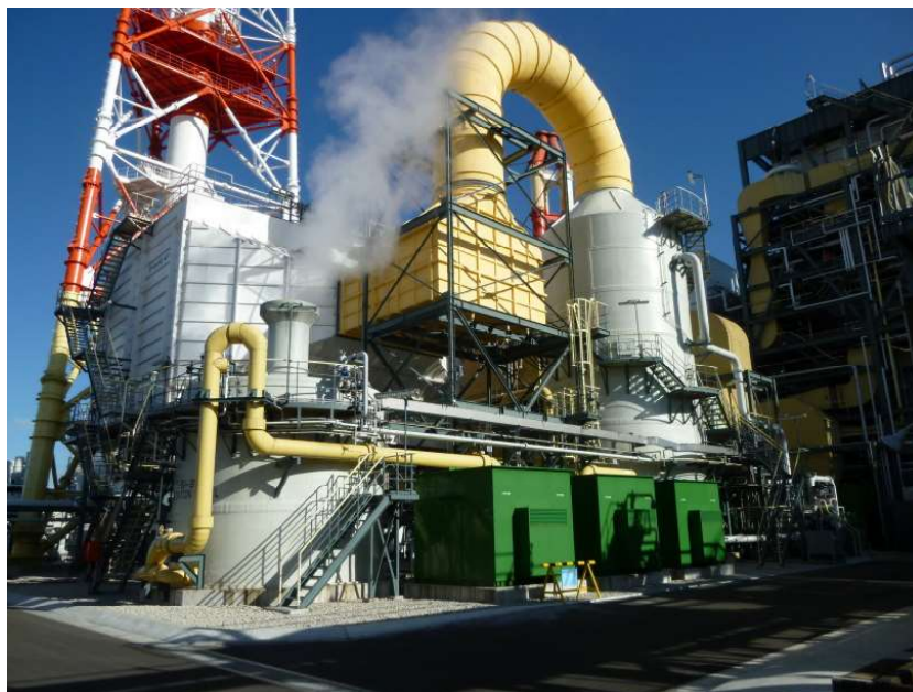
写真5-1-4 用役施設地区（富士石油株式会社提供）
