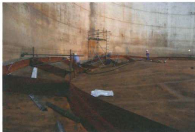
写真10-5-1 浮き蓋の破損状況
