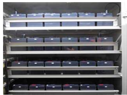
写真6-3-4 非常電源設備（蓄電池）の例
