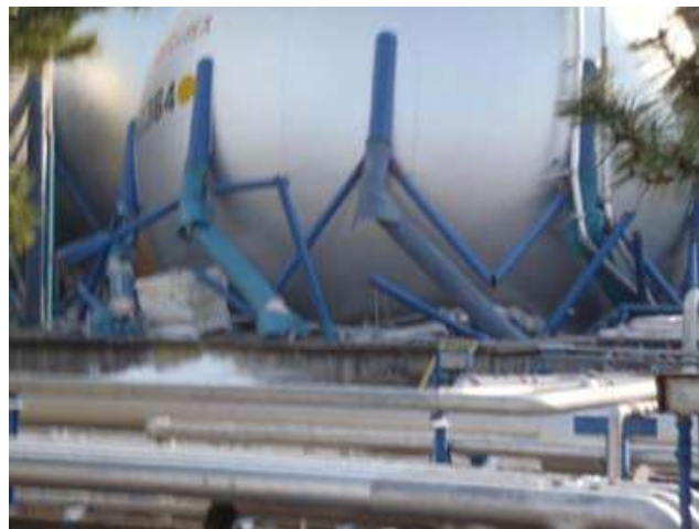
写真10-2-1 364番タンク 15時20分頃の状況
