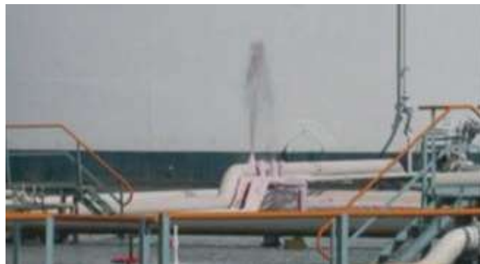
写真10-3-4 ベントから噴出するガソリン(高さ約2m)
