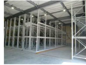
④屋内貯蔵所の移動式架台
