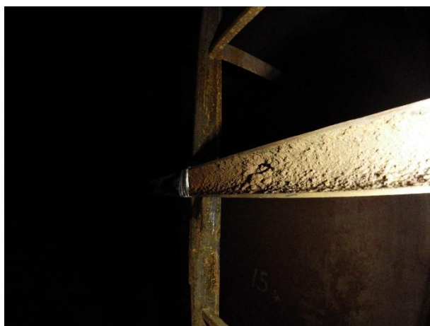
腐食のテストピース
