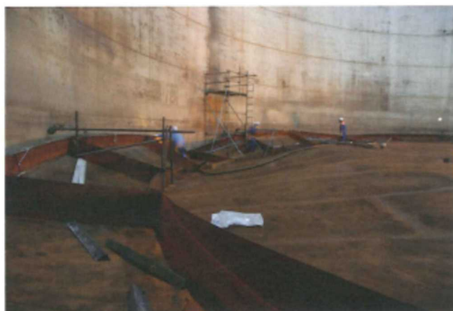
写真 10-5-1 浮き蓋の破損状況
