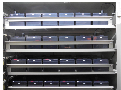
写真 6-3-4 非常電源設備（蓄電池）の例
