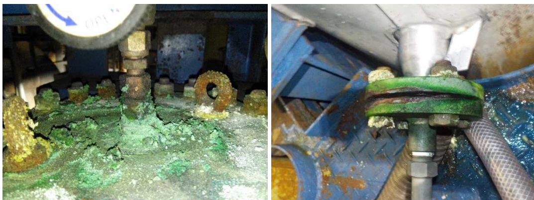
写真 8－3－2 フッ化水素の漏えい痕（金属の腐食による結晶物）
