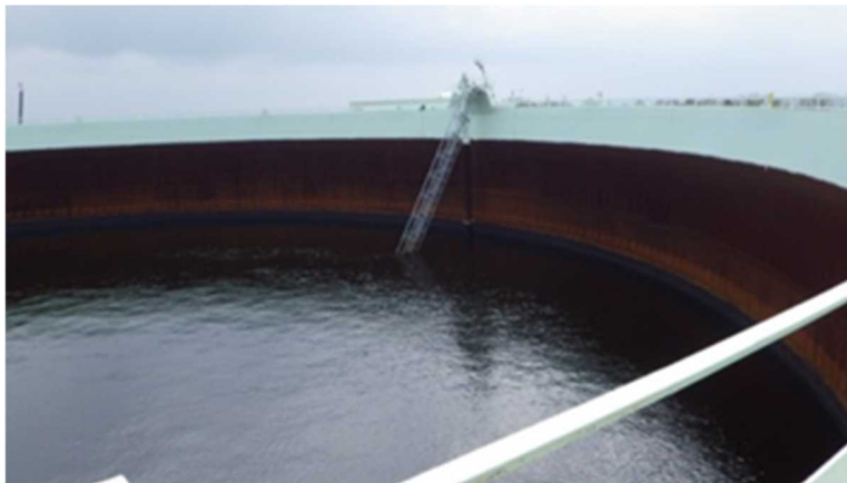
写真 10-4-2 浮き屋根が完全に沈んだ状態
