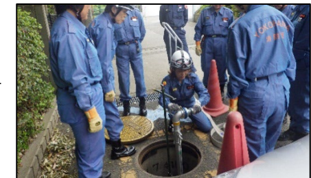
【スタンドパイプ取扱訓練の様子】
