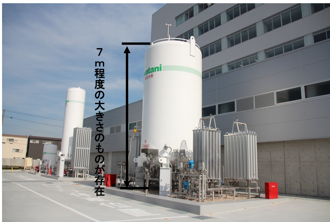
図 3.3 液化水素貯槽の例
