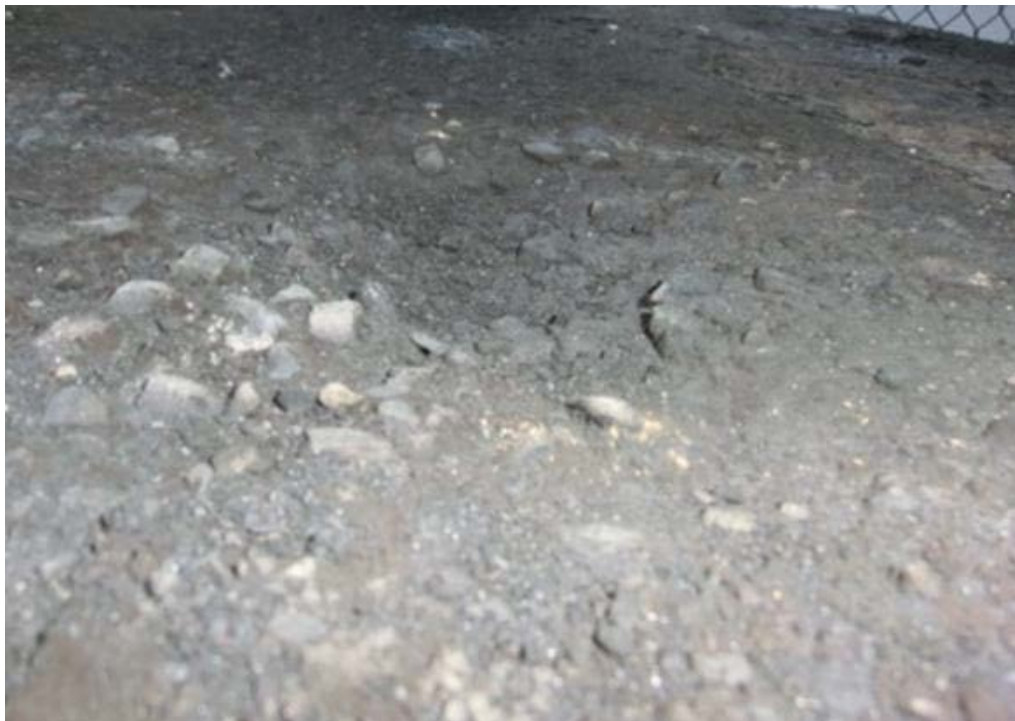
図 20 路面の焼損状況
