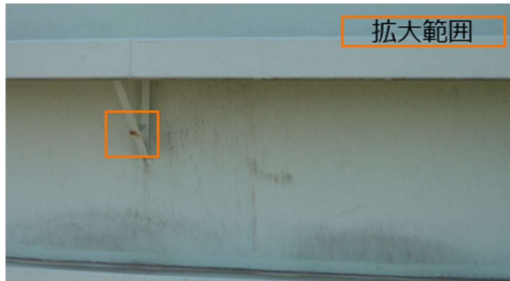
図 41 検証に用いた腐食
