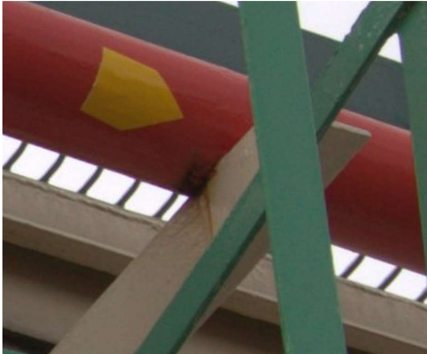
図 16 図 15 の一部を拡大した静止画（配管腐食の様子）
