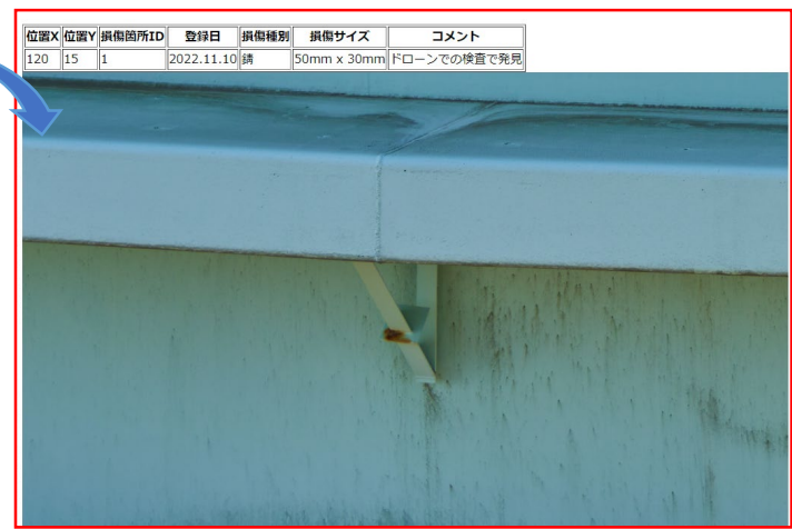
クリックすると腐食/損傷の詳細静止画が表示される (イメージ)
