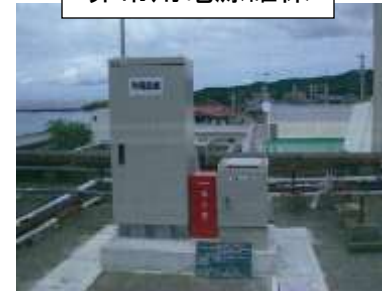
非常用電源確保
