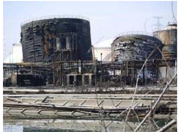
焼損した屋外貯蔵タンクの外観
