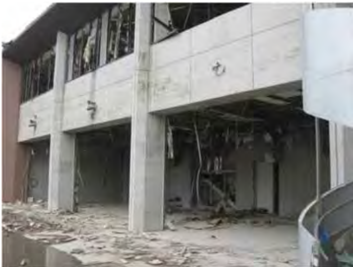
女川消防署の被災状況
