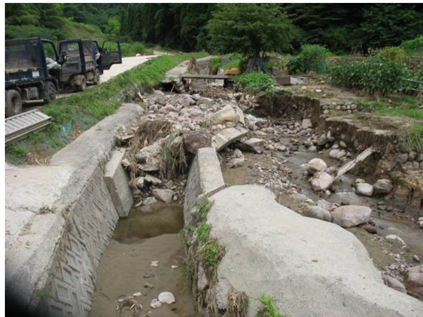
河川災害（北袋町地内）（金沢市提供）
