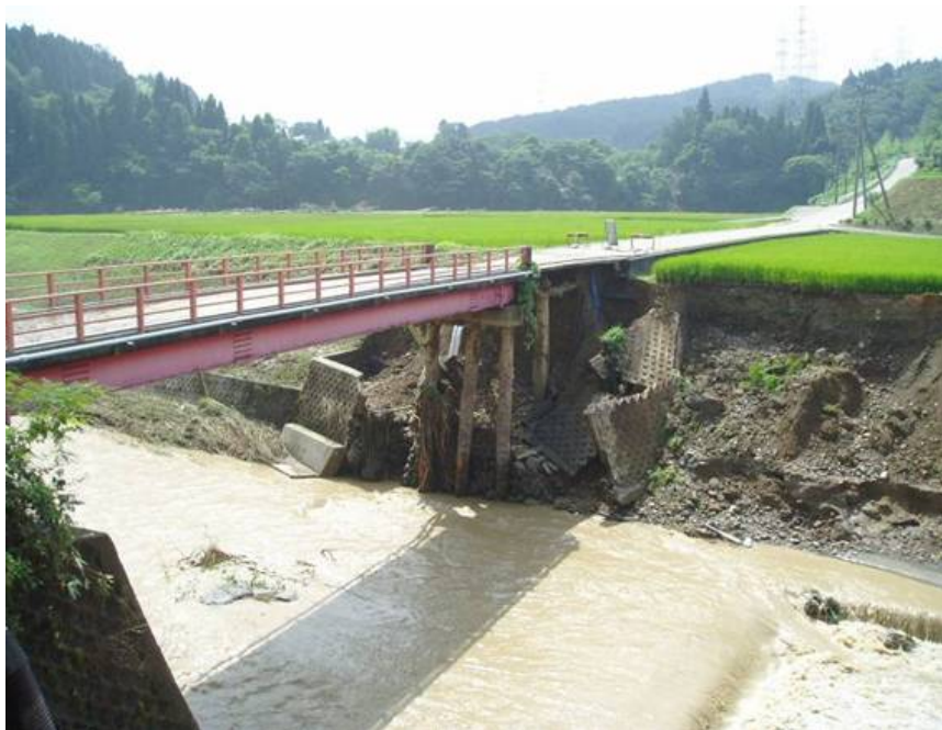
道路災害（七曲橋 七曲町地内）（金沢市提供）
