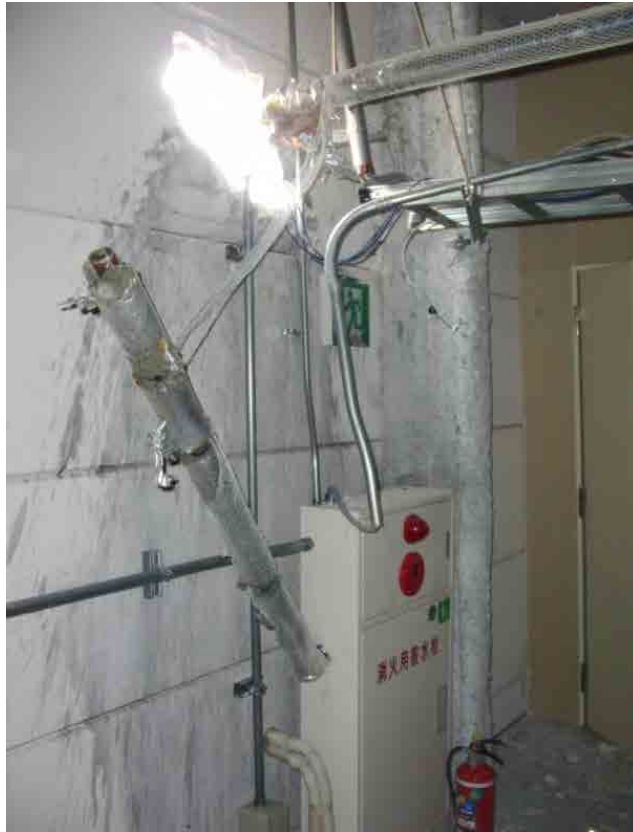
地震の揺れにより補助散水栓の配管が破断した事例（平成23年6月6日撮影）
