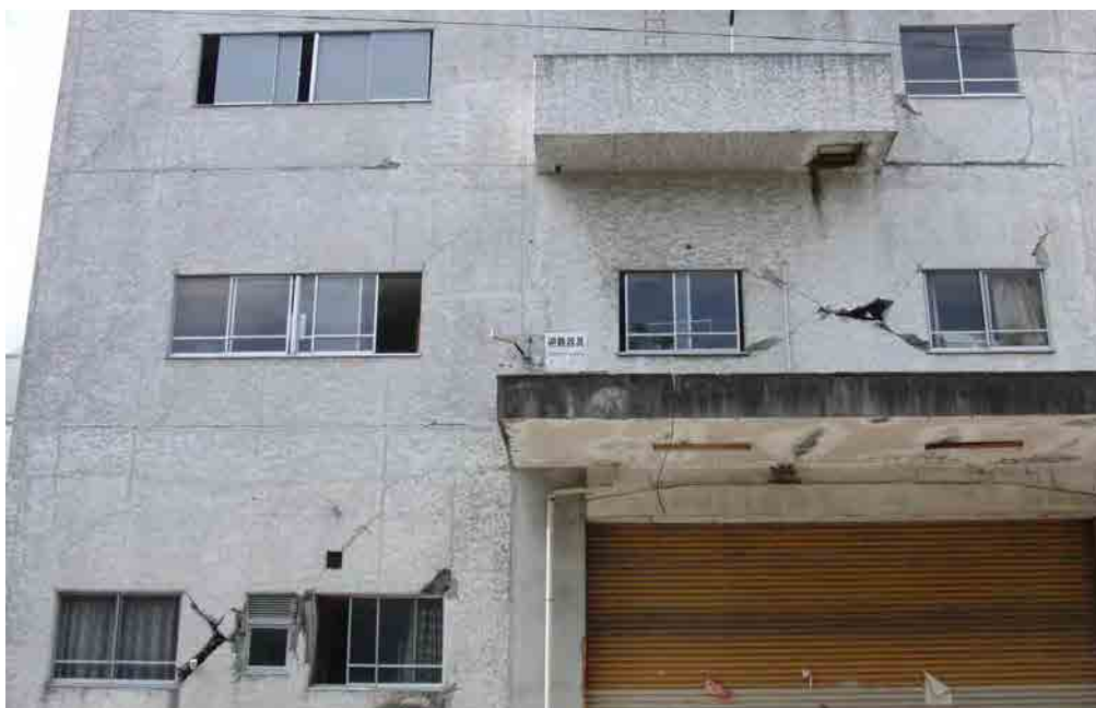
地震により外壁に大きなひびが入った建物（平成23年6月16日撮影）
