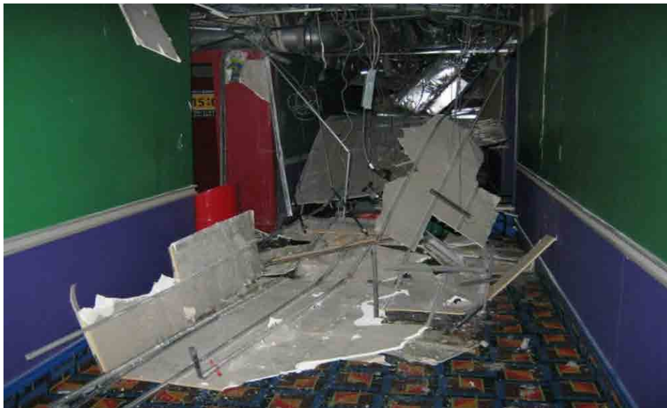
天井が落下し、スプリンクラー配管が破損した事例（平成23年6月6日撮影）
