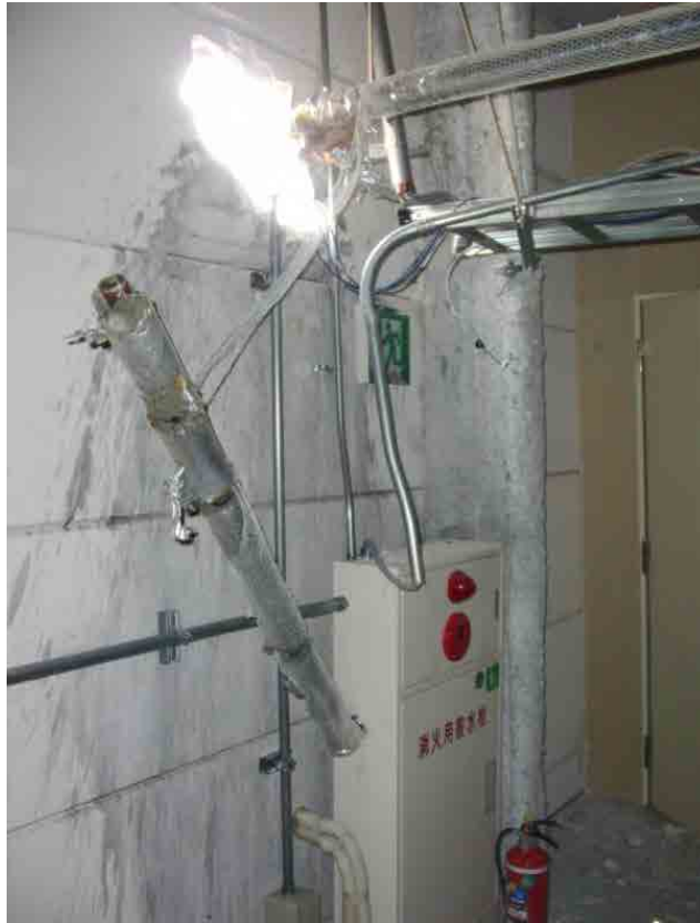
地震の揺れにより補助散水栓の配管が破断した事例（平成23年6月6日撮影）
