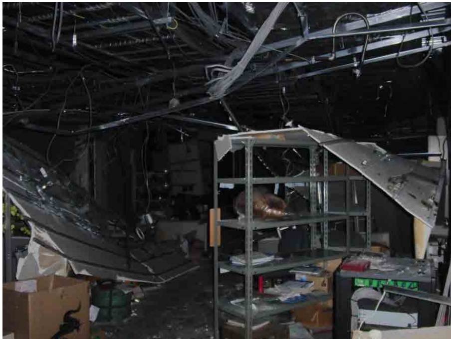
地震の揺れにより大きな被害を受けた室内（平成23年6月6日撮影）
