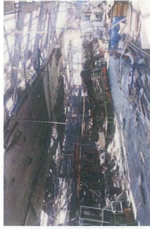
焼損した施設の状態
