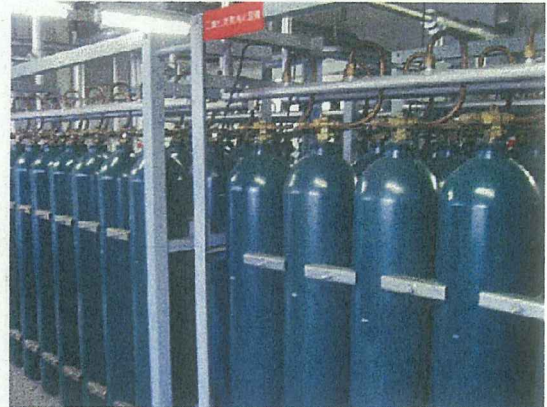
<窒素消火設備>
