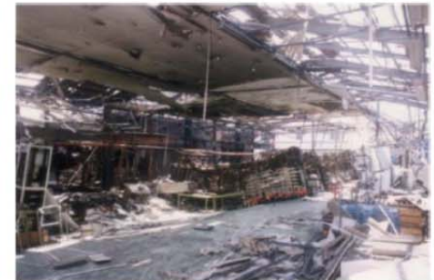
焼損した施設の状況
