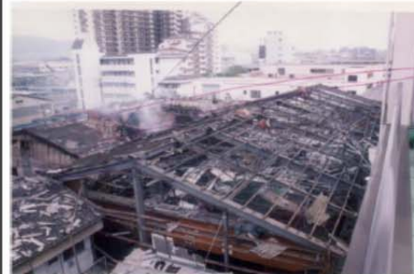
火災で吹き飛んだ屋根
