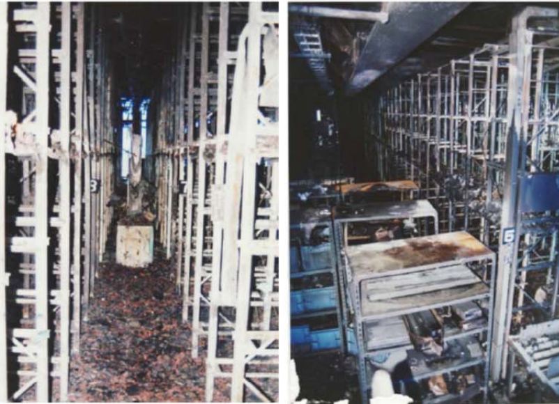
倉庫部分の焼損状況
