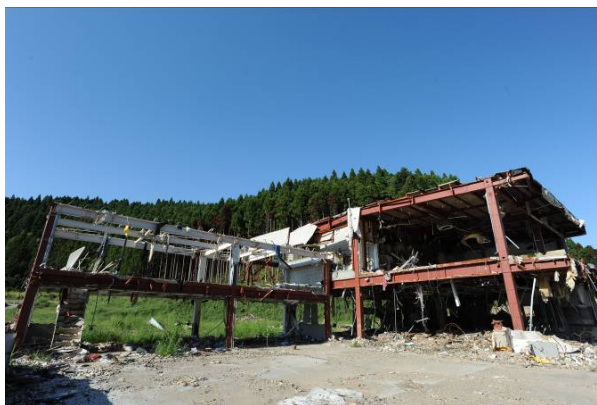
津波被害により全壊した気仙沼・本吉本部歌津出張所
