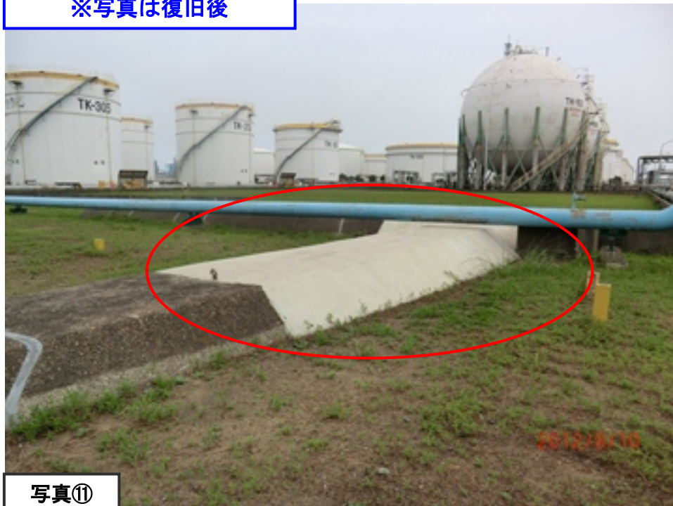
盛土構造の陥没 ※写真は復旧後
