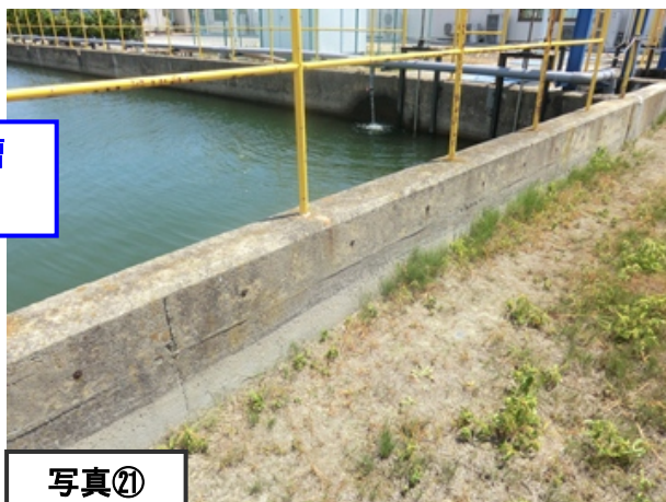
コンクリート製貯水槽 （ひび割れ，漏水）
