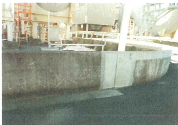
（コーキング材及びセメントで補修した例）
