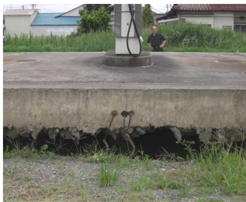
液状化による上部スラブの浮き上がり (出典:全国危険物安全協会)
