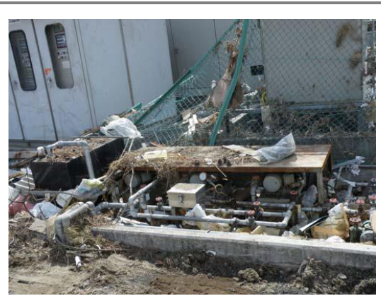
ポンプ設備の津波による被災状況 (出典：消防庁)
