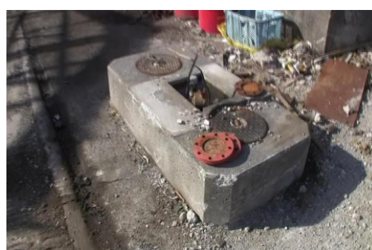
固定給油設備が欠損したアイランド (出典:危険物保安技術協会)
