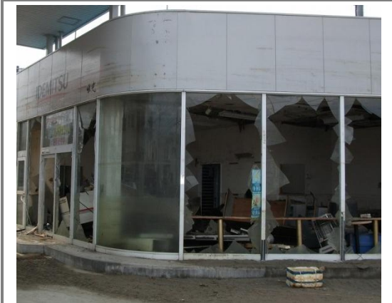
津波により破損した建築物(サービスルーム) (出典:全国危険物安全協会)
