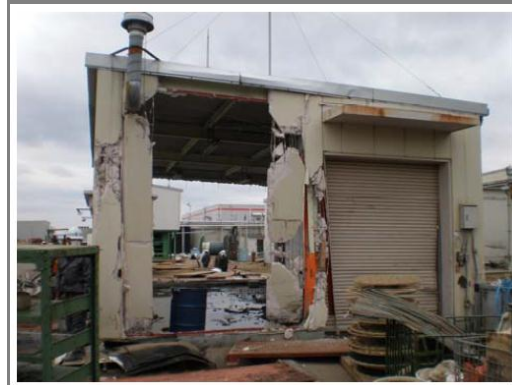
津波により破壊された外壁 (出典：消防庁)
