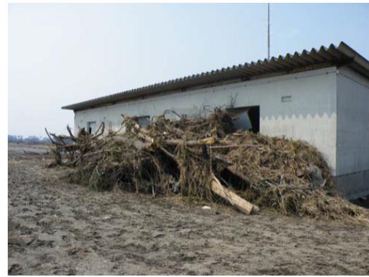
津波により土砂が堆積した様子 (出典：消防庁)
