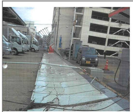
地震により倒壊した防火塀 (出典:仙台市消防局)
