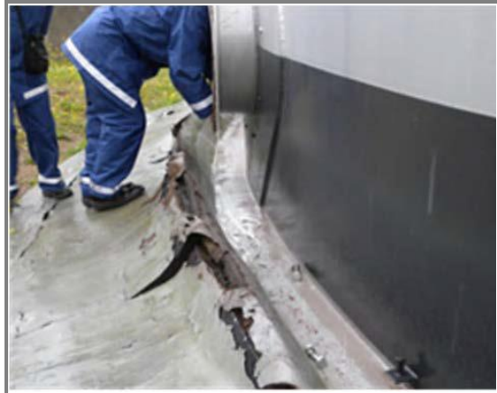
地盤の不等沈下によるタンクの沈下、 アニュラ板付近の変形状況 (出典：消防研究センター)
