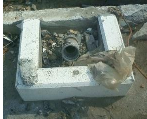
津波により破損した注入口 (出典:全国危険物安全協会)
