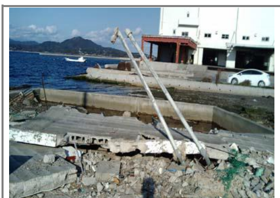
倒壊した防火塀と曲げられた通気管 (出典:危険物保安技術協会)
