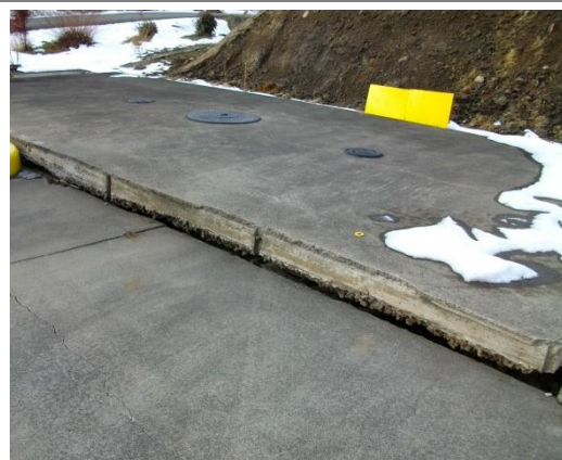
液状化による上部スラブの浮き上がり (出典:全国危険物安全協会)
