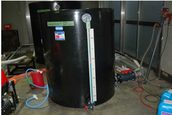
泡水溶液水槽
