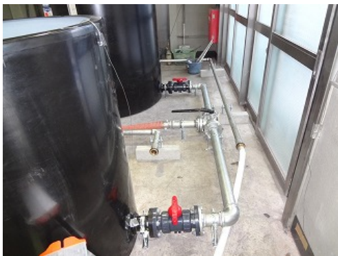
ポンプー次側配管
