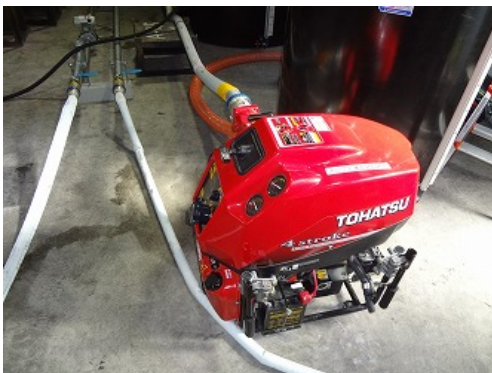
加圧送水用の動力消防ポンプ
