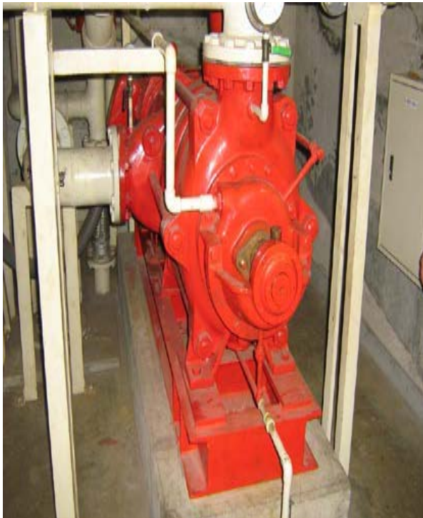
ポンプ側分解前
